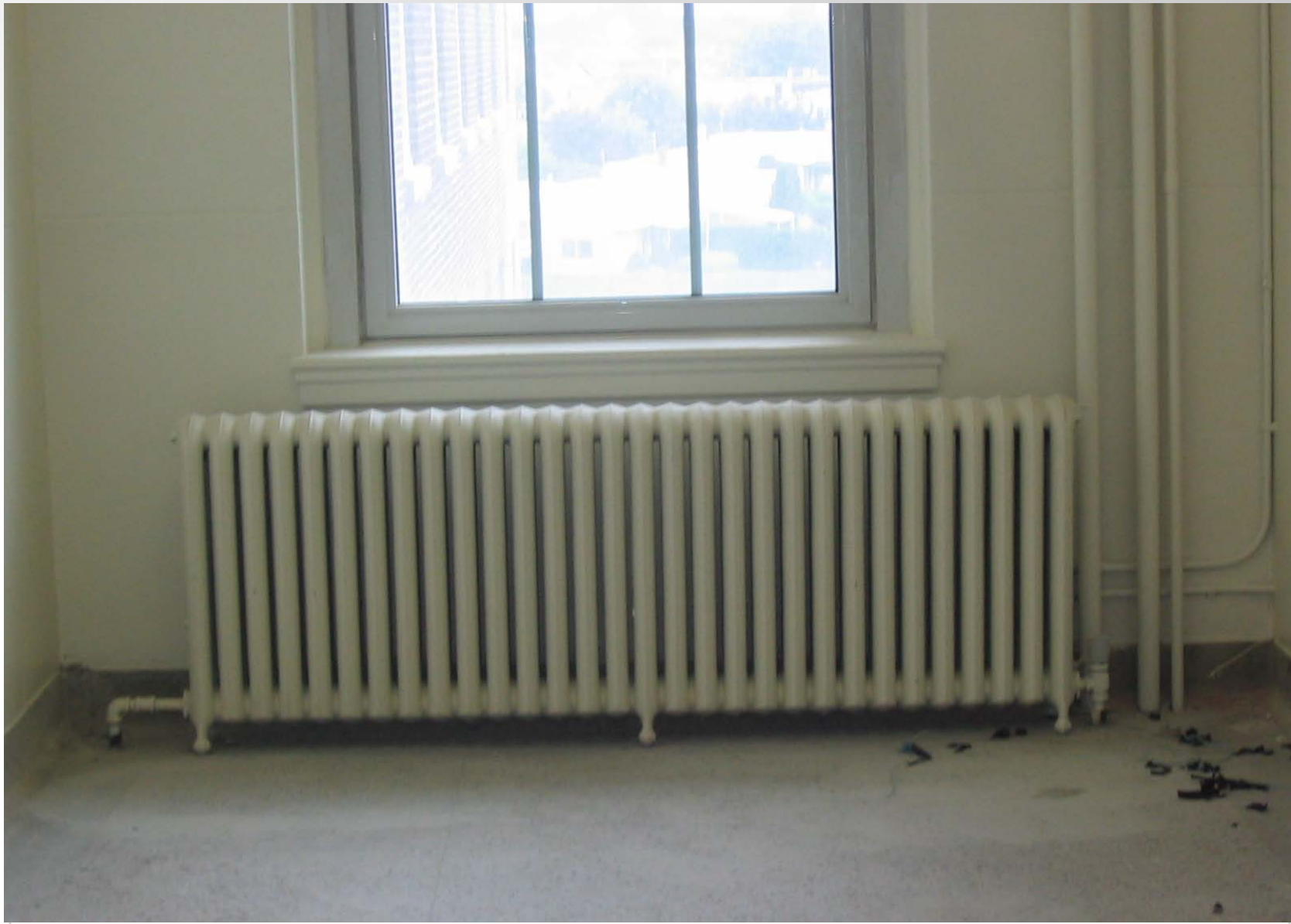
Chauffage à basse température
