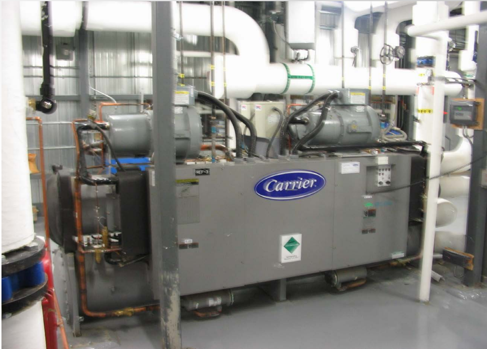
Pompes à chaleur (refroidisseur)
