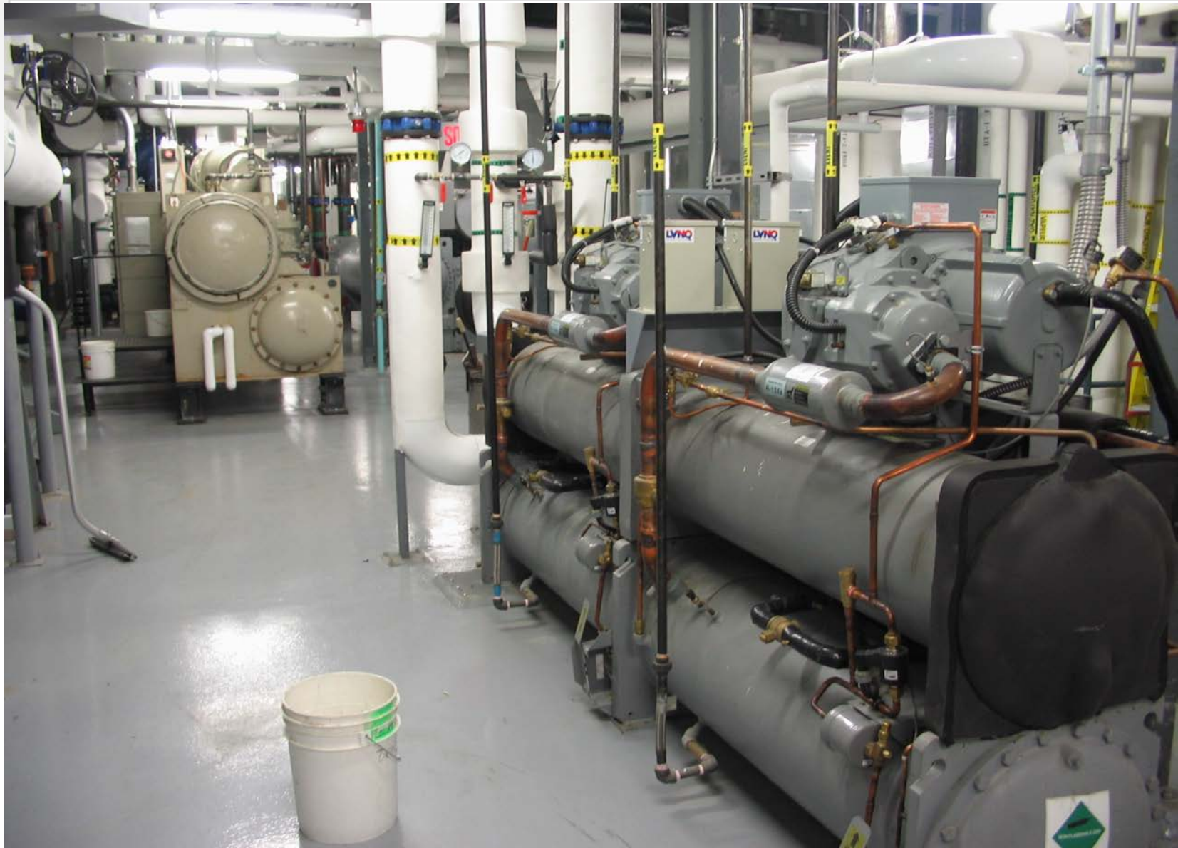
Pompes à chaleur (refroidisseur)
