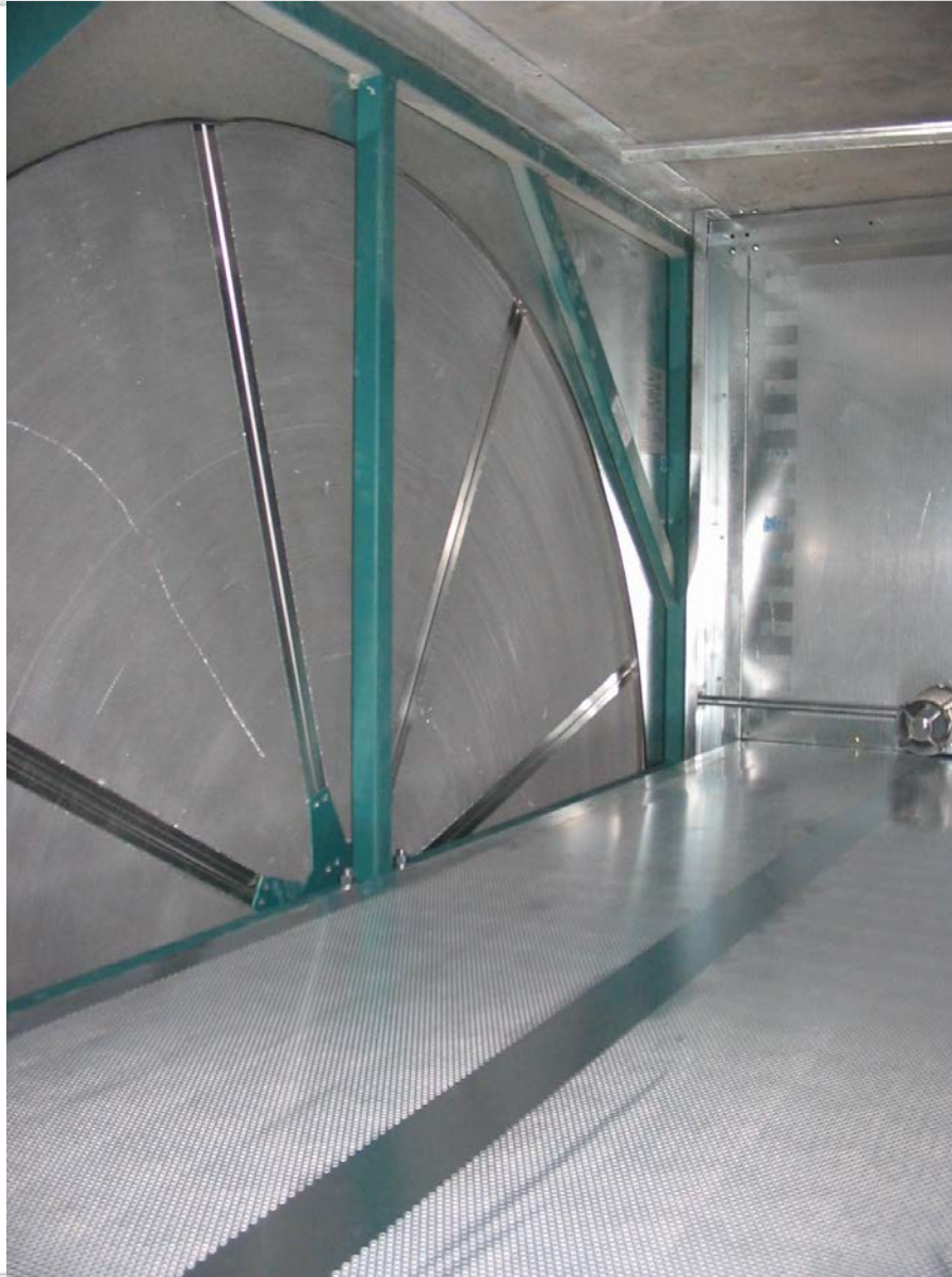
Roue thermique (chaleur : latente et sensible)
