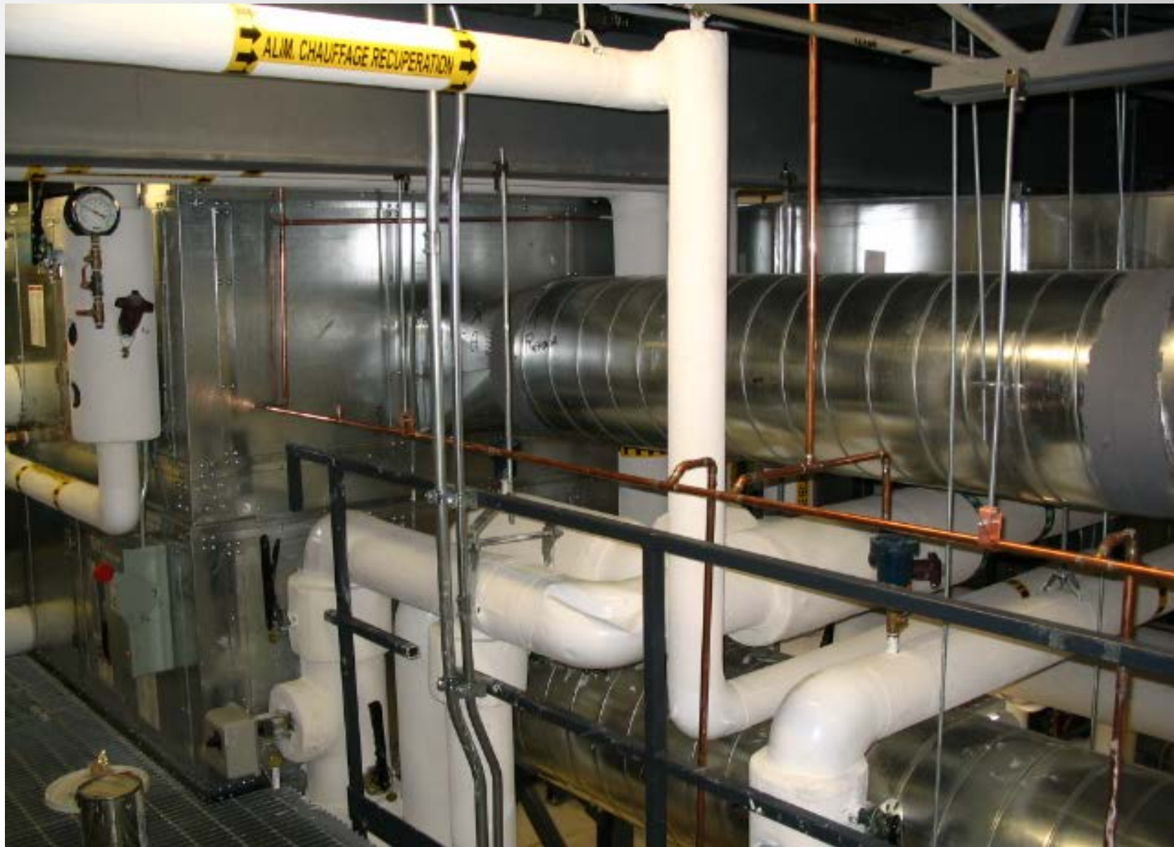
Récupération de la chaleur des évacuations
