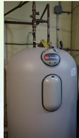
Chauffe-eau haute température avec valve thermostatique
